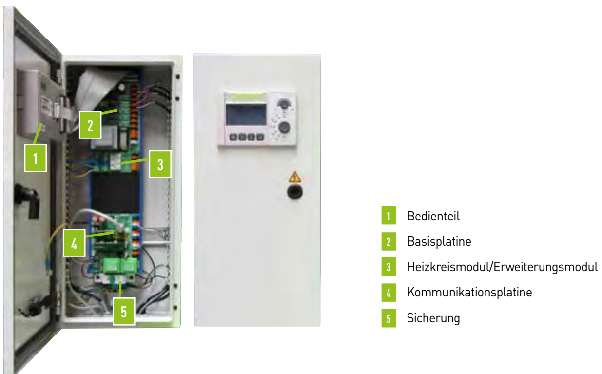
Abb. 23: Schaltschrank für die Übergabetechnik
