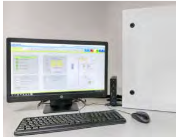
Abb. 38: E-CONTROL mit Bildschirmanzeige Heizhaus
